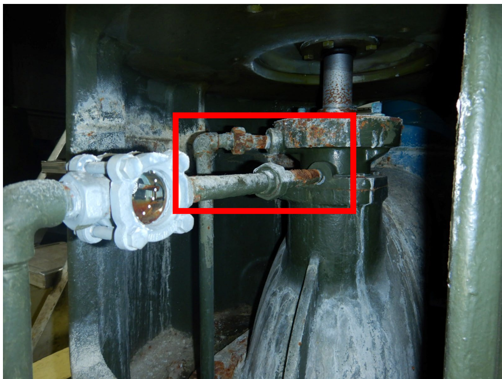
写真 2 補機系揚水ポンプシール水配管及びドレン配管
