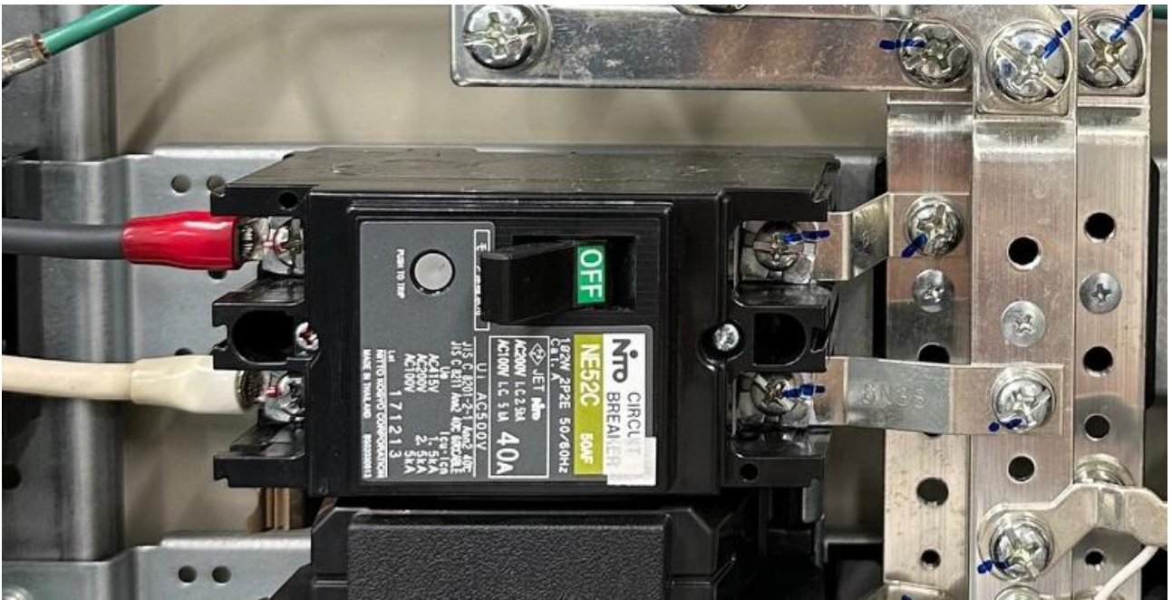
図 1. 分電盤 40A 分岐ブレーカー写真
