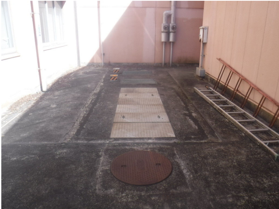
ブースターの浄化槽
