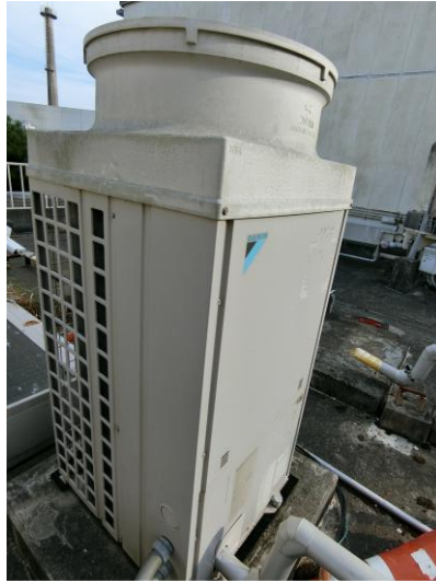
図6 107室にあるエアコンの室外機（2階屋上）
