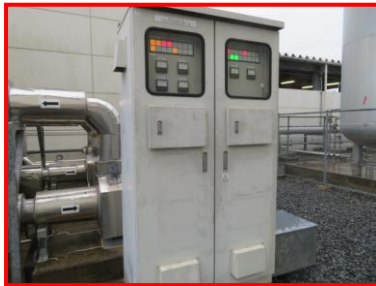
冷却塔運転制御盤 (4. 計装 (電装品))
