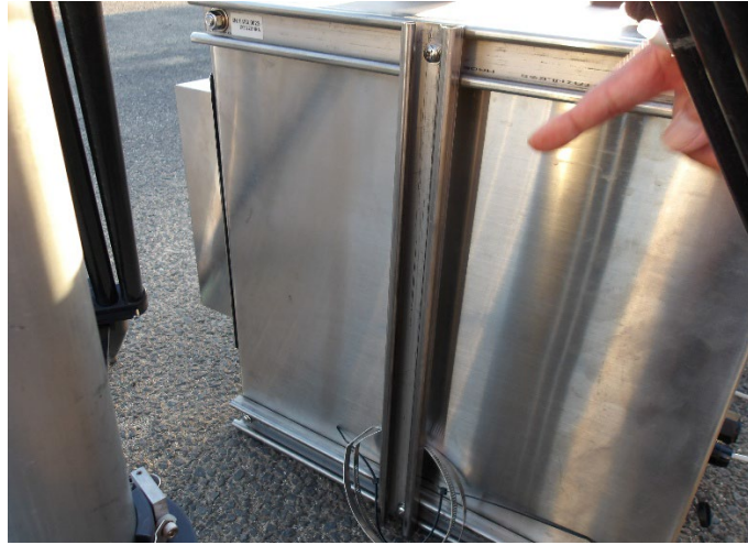
写真3 付属電源盤裏側
