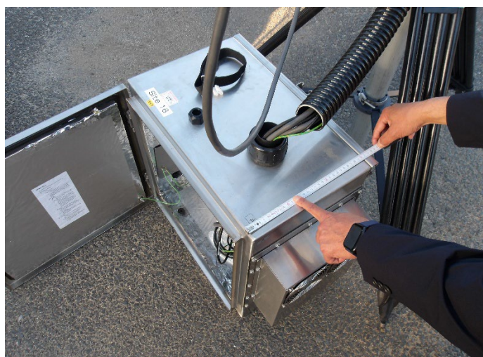
写真2 付属電源盤外観
