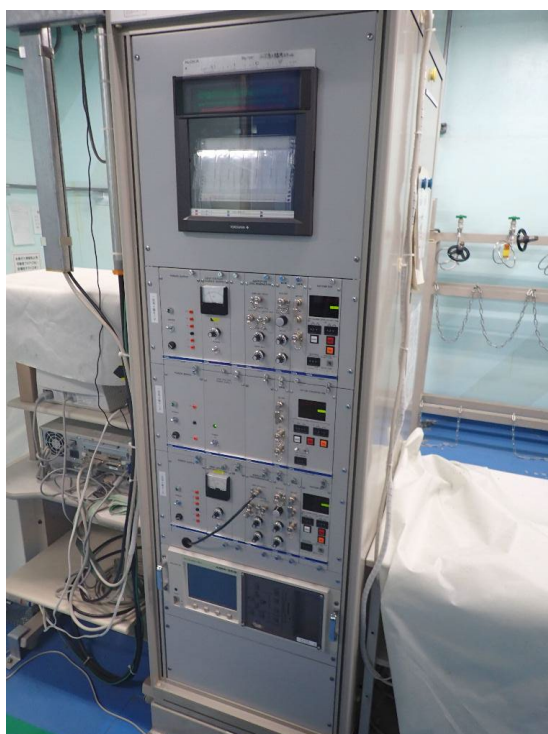
図6：ヘリウムサンプリング設備監視盤 (更新対象は盤内の記録計及び計測モジュール)
