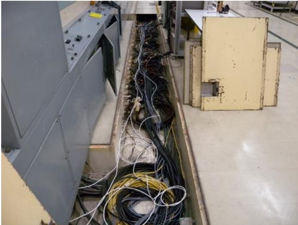
MMF-2操作室のトレンチ下
