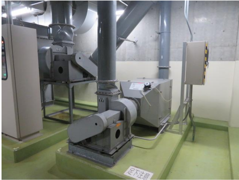
更新対象の乾式排ガス処理装置の写真
